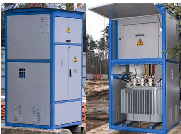
Рис. 2.8 – Загальний вигляд КТП
